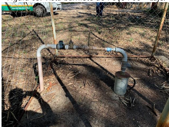
Figura 63. Vista barrilete do Poço P08 – Laje.
