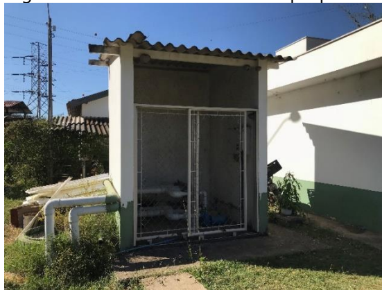
Figura 125. Vista da EEE 05 no tanque pulmão.
