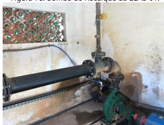
Figura 78. Bomba de Recalque da EEAB 01.
