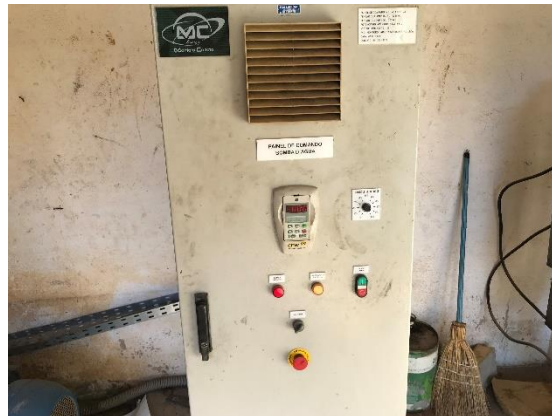
Figura 17. Vista Geral do painel elétrico das bombas.
