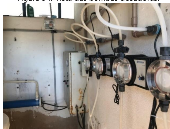
Figura 94. Vista das bombas dosadoras.
