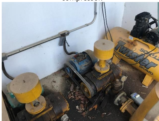
Figura 129. Vista dos sopradores e do compressor.
