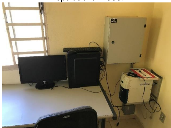
Figura 134. Vista da central de controle operacional - CCO.
