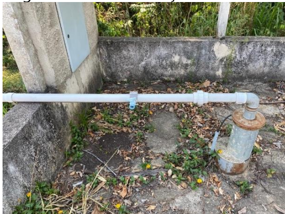
Figura 75. Vista do Poço P10 – Olaria.
