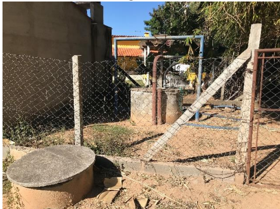
Figura 138. Vista geral da estação elevatória de esgoto 1.
