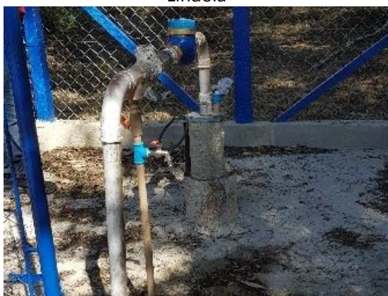
Figura 49. Vista Geral do Poço 06 – Jardim Lindóia
