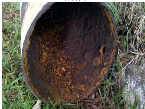
Figura 163. Vista de incrustação em tubulação adutora.
