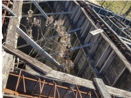
Figura 100. Expansão da ETA, obra paralisada
