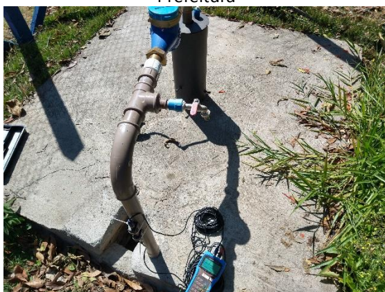
Figura 31. Vista do barrilete do Poço 02 - Prefeitura
