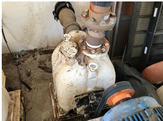
Figura 148. Vista do conjunto motor bomba operacional.
