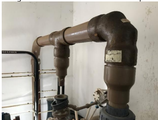
Figura 123. Vista do barrilete de recalque.
