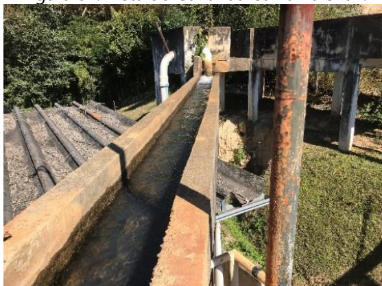
Figura 87. Vista do Canal da Calha Parshall.
