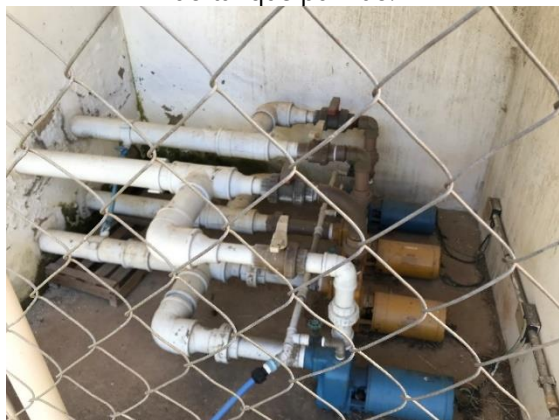
Figura 126. Vista dos conjuntos motor-bomba do tanque pulmão.
