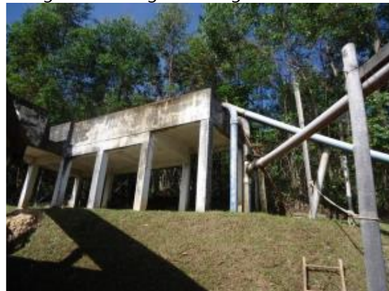
Figura 86. Chegada da Água Bruta na ETA.
