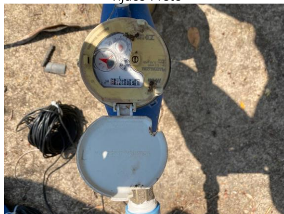
Figura 59. Vista barrilete do Poço P07 – Tijuco Preto
