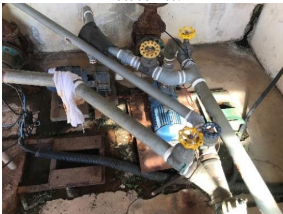
Figura 104. Vista Geral do conjunto motobomba.
