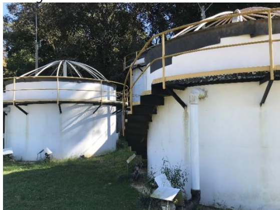
Figura 120. Vista dos Biofiltros Aerados.
