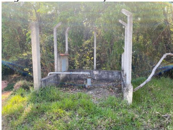
Figura 73. Vista do Poço P10 – Olaria.
