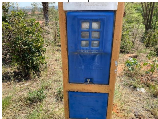
Figura 47. Caixa de Energia do Poço 05 – Parque Aquático
