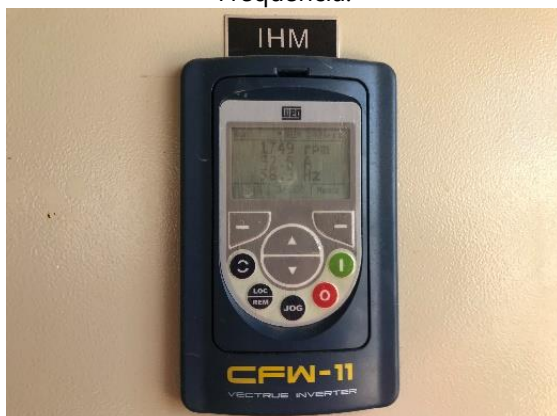
Figura 97. Vista de equipamento – Inversor de Frequência.
