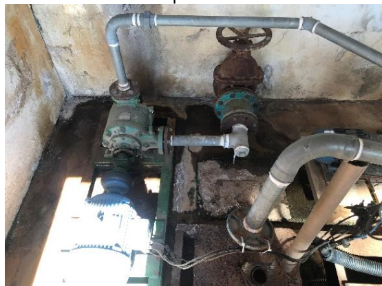
Figura 98. Vista Conjunto Motobomba - Bombeamento para os reservatórios.
