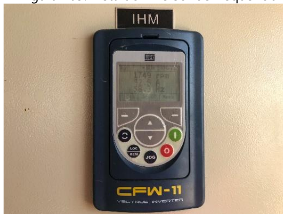
Figura 109. Vista do Inversor de frequência
