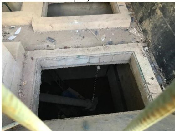
Figura 20. Vista Geral do sistema recalque da captação 02.
