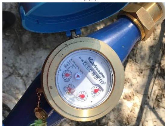
Figura 52. Vista medidor de vazão – Jardim Lindóia
