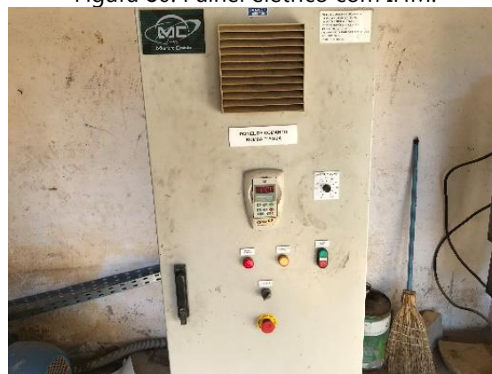
Figura 80. Painel elétrico com IHM.
