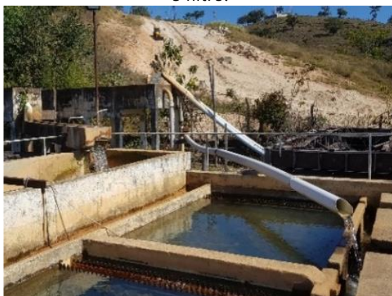
Figura 89. Vista dos decantadores, floculadores e filtro.
