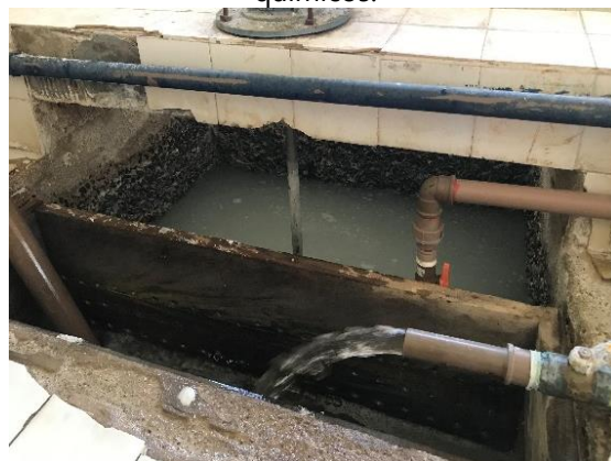
Figura 96. Vista de tanque de adição de químicos.
