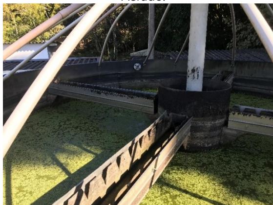
Figura 132. Vista do vertedor do Biofiltro Aerado.
