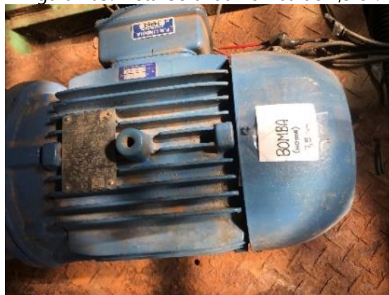
Figura 105. Vista Geral da Bomba de 7,5 cv.
