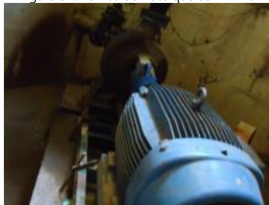
Figura 82. Bomba de Recalque da EEAB 02
