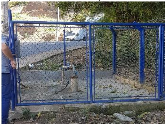
Figura 24. Vista Geral do Poço 01 - João Toledo.
