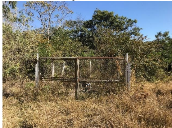
Figura 57. Vista barrilete do Poço P07 – Tijuco Preto
