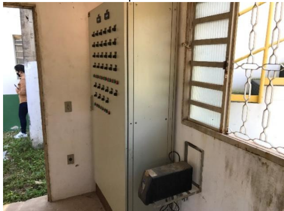
Figura 130. Vista do painel de comando dos sopradores.
