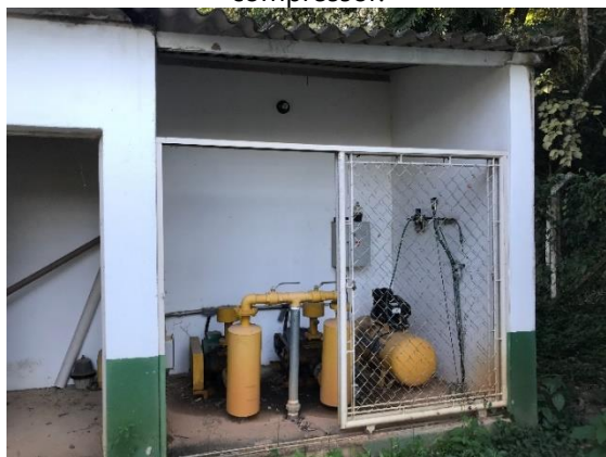
Figura 128. Vista do abrigo dos sopradores e compressor.
