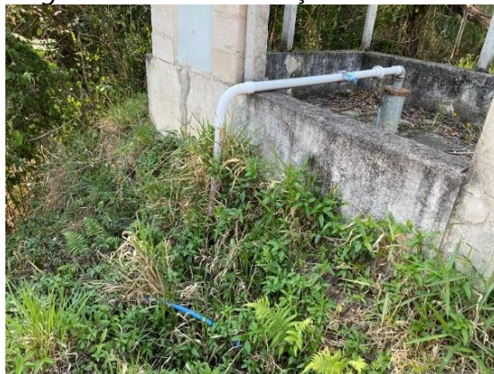
Figura 74. Vista do Poço P10 – Olaria.
