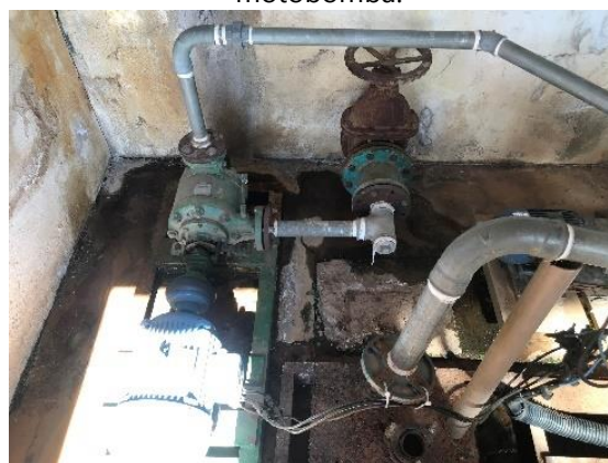
Figura 103. Vista Geral do conjunto motobomba.
