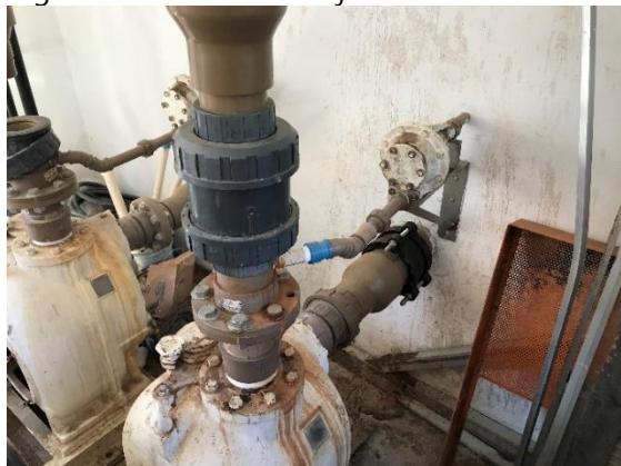
Figura 122. Vista dos conjuntos motor-bomba.
