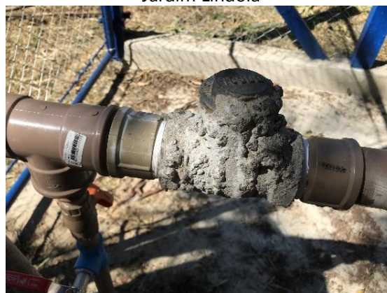
Figura 50. Vista barrilete do Poço 06 – Jardim Lindóia
