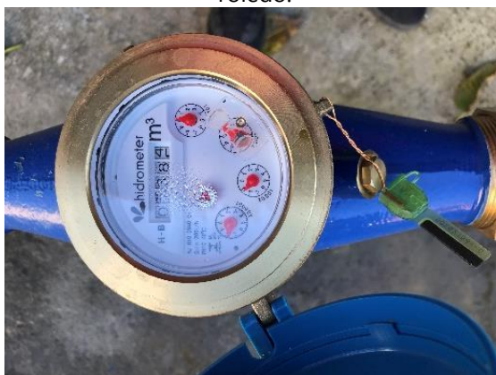
Figura 26. Vista do hidrômetro do Poço 01 - João Toledo.
